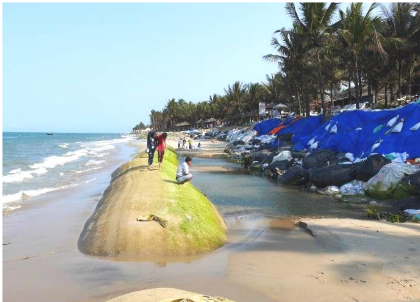
Hình 8. Một đoạn bờ biển Cửa Đại bị xói lở do sóng đánh đã được gia cố bằng bao cát năm 2016 nhưng không hiệu quả. Biển tiếp tục lấn vào bờ và gây xói ở bờ biển nghiêm trọng.
